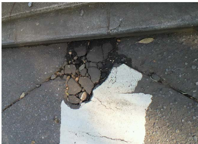
遮断機付近欠損部
