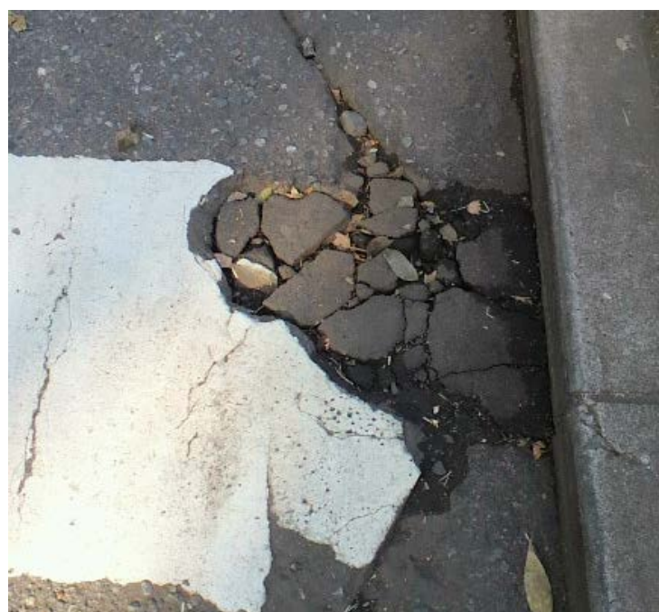
劣化状況(拡大)
