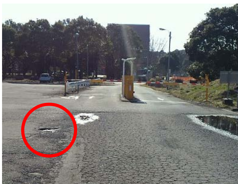
劣化部分(赤丸内)
