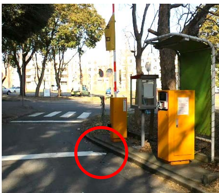
劣化部分(赤丸内)
