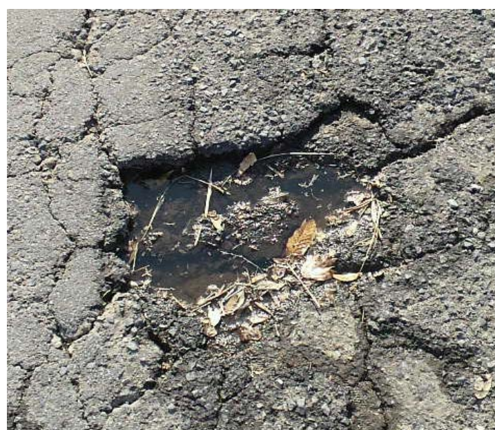
劣化状況(拡大)
